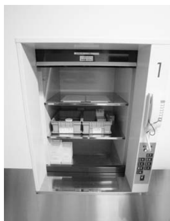
病棟間の検体搬送用ダムウエーター
